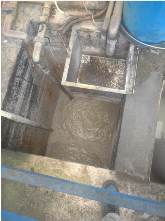
Bể điều hòa 1 (hóa lý)
