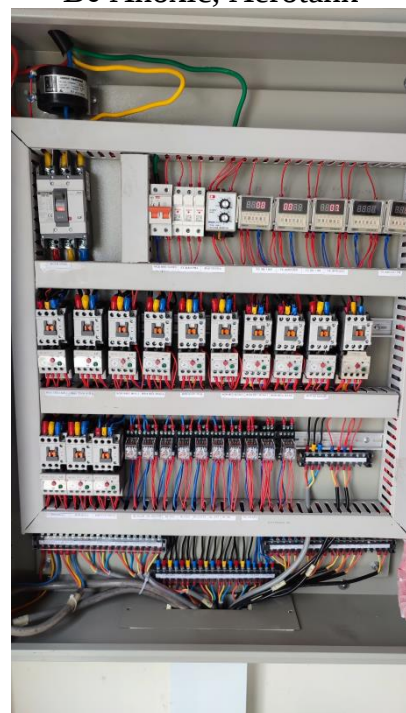
Tủ điện điều khiển
