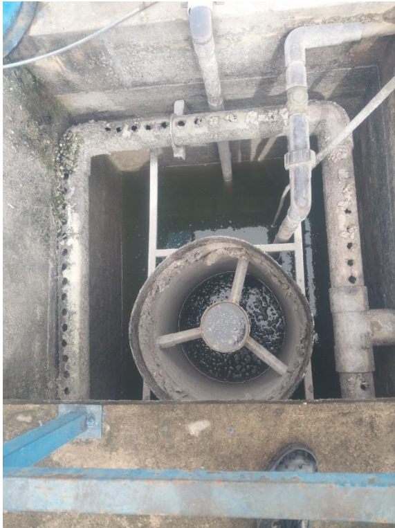
Bể lắng (hóa lý)
