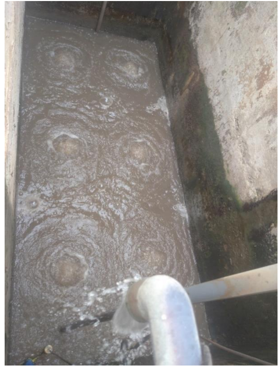
Bể điều hòa 2 (sinh học)
