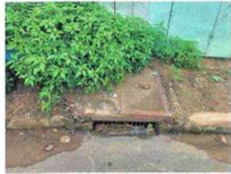
HỒ GA NƯỚC MƯA ĐƯỜNG NHỰA PHÍA BẮC
