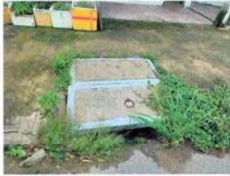
HỒ GA NƯỚC MƯA ĐƯỜNG AN PHÚ 17
