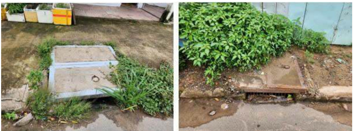
Hình 1.3: Hệ thống thoát nước mưa trên đường các tuyến giao thông hiện hữu
