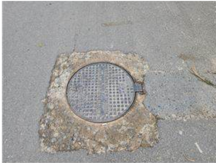
Hình 4. 4: Hình ảnh hố ga đầu nối nước thải của dự án trên đường An Phú 16
