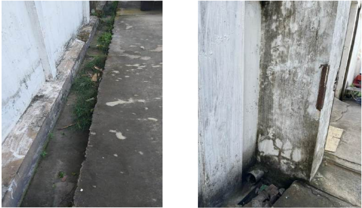
Hình 3.2. Hệ thống mương thu gom và thoát nước mưa tại cơ sở
