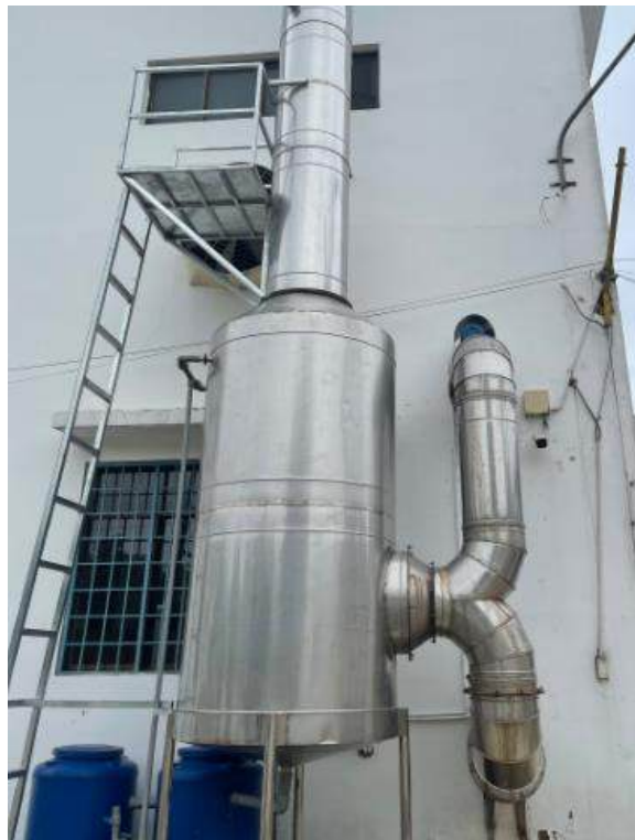
Đường ống thu gom chính
