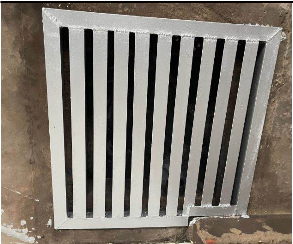
Hình 3. 2: Hố ga thu nước của nhà máy
