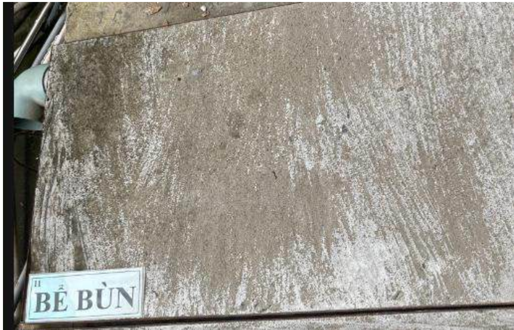
Hình 3. 17: Bể chứa bùn
