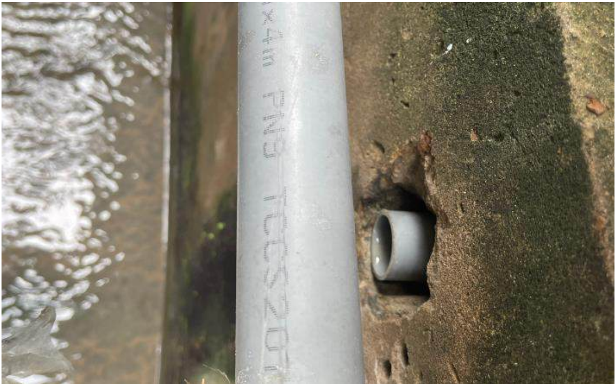
Hình 3. 5: Ống thoát nước thải sau xử lý
