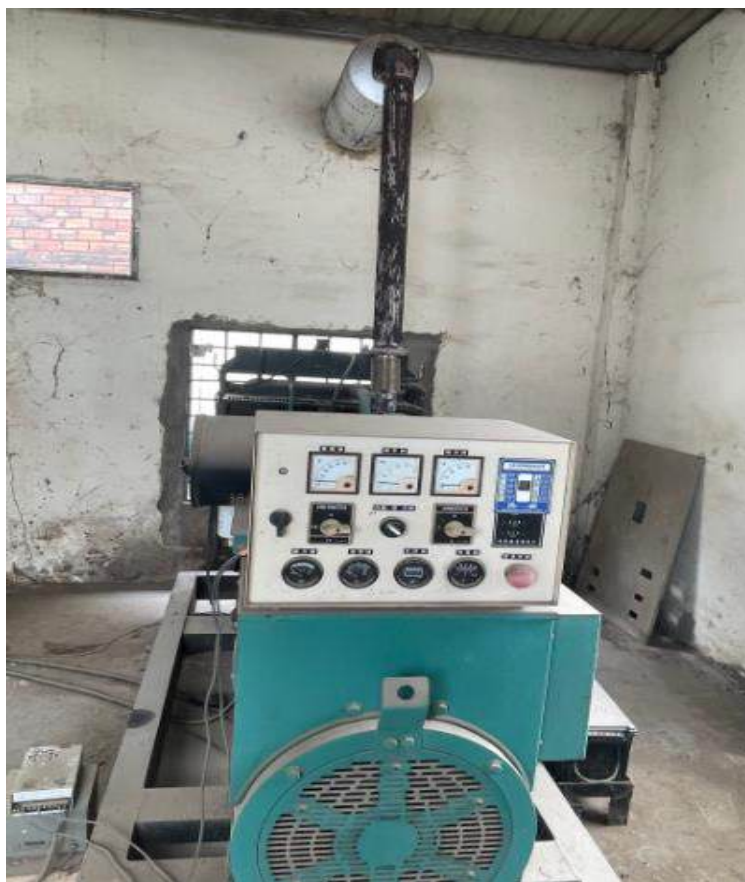
Máy phát điện công suất 90 KVA
