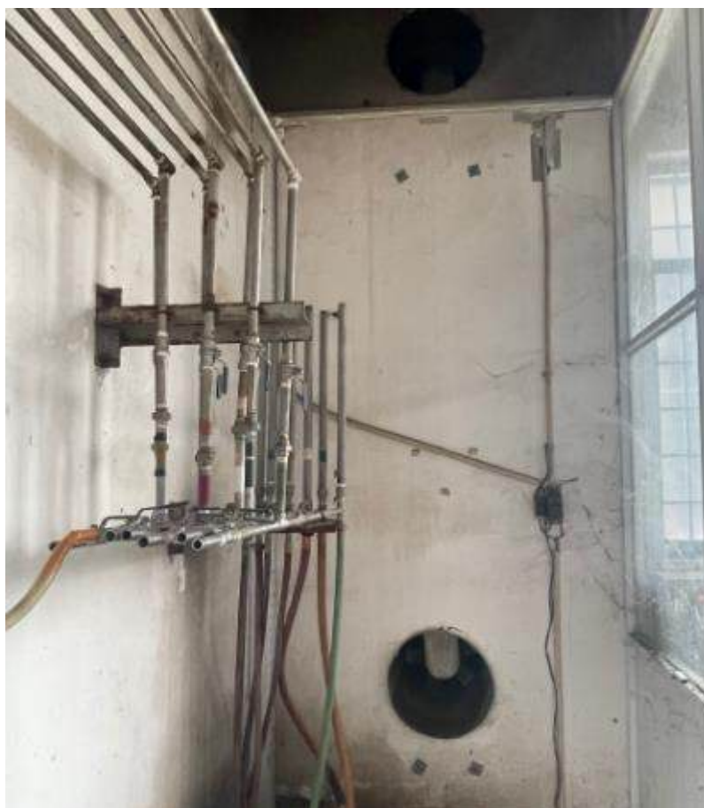
Hệ thống thu gom khí thải từ 7 lò nung
