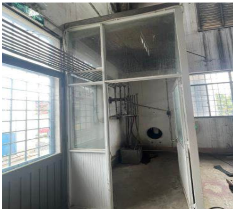
Hệ thống tu gom khí thải từ 7 lò nung
