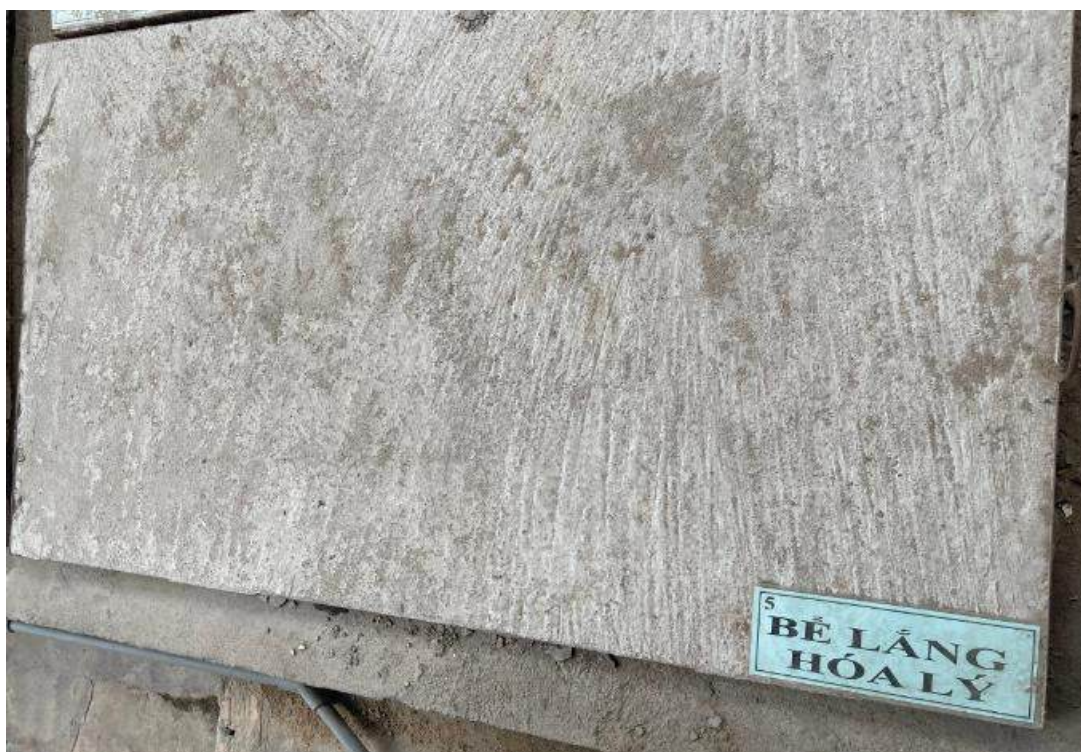
Hình 3. 11: Bể lắng hóa lý
