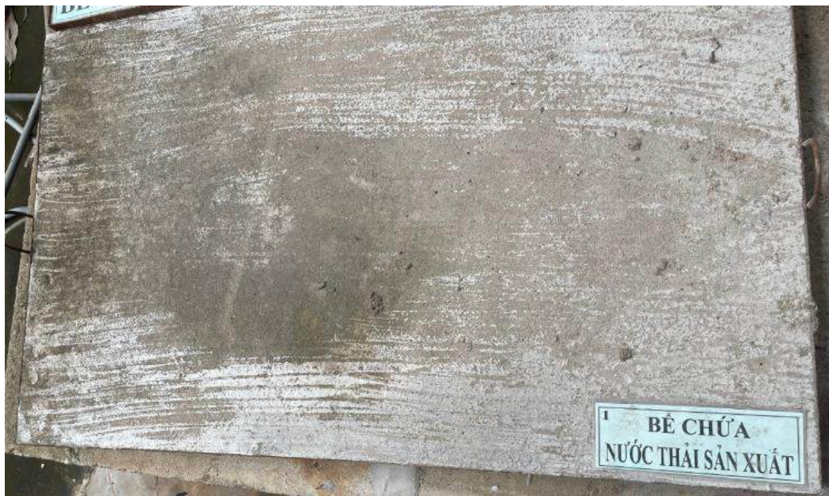
Hình 3. 8: Bể chứa nước thải sản xuất
