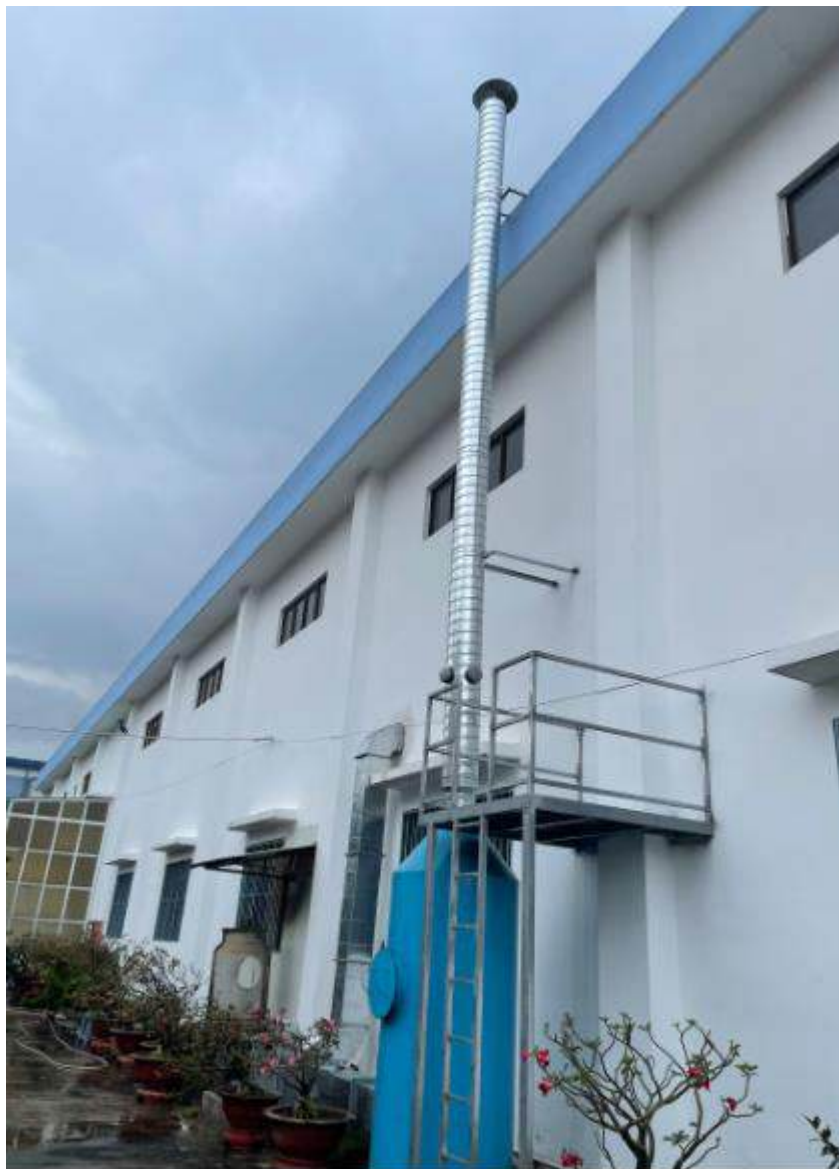
Hình 3. 23: Hệ thống thu gom, xử lý khí thải lò nung
