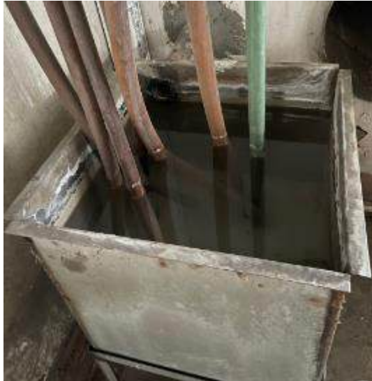
Bể chứa nước (thông ống khí bị ngẹt)
