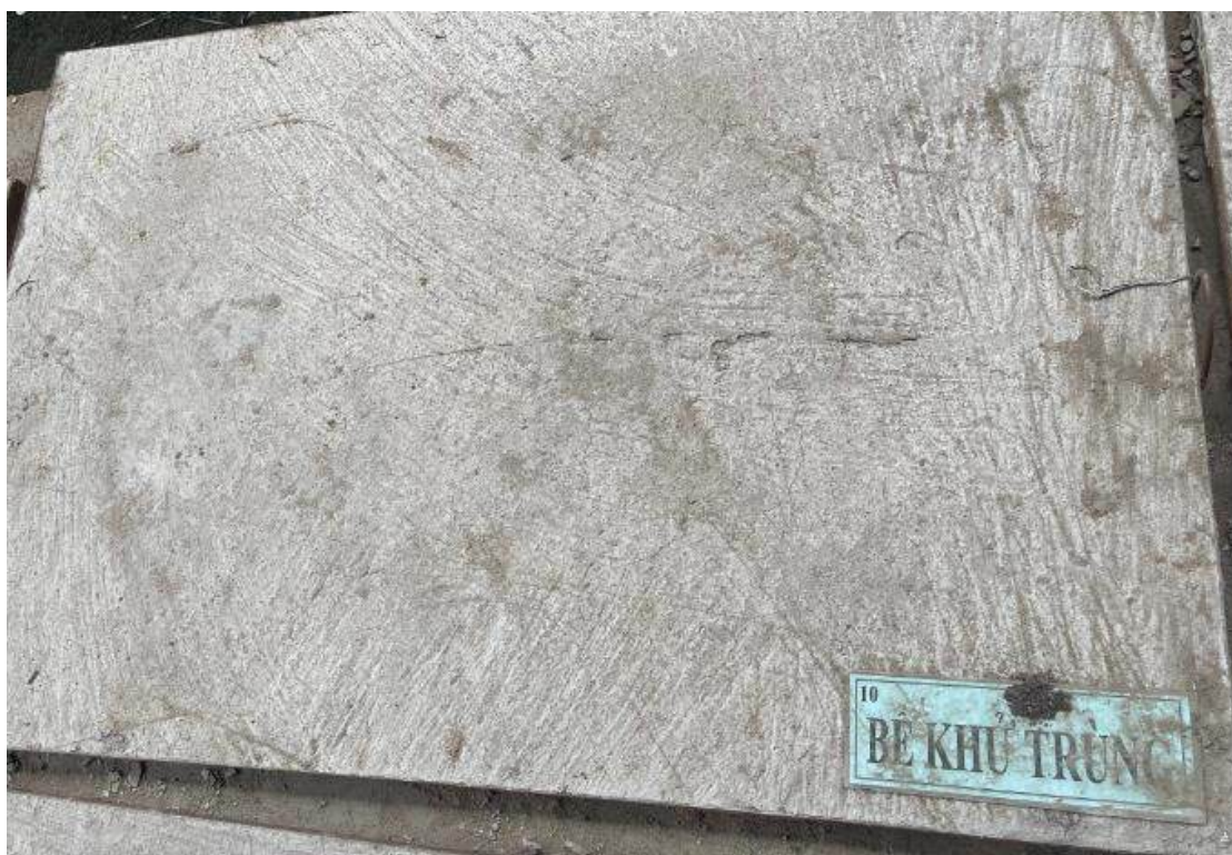
Hình 3. 16: Bể khử trùng
