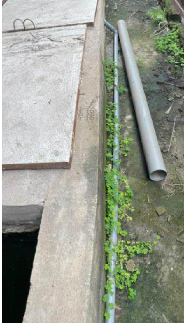
Hình 3. 4: Đường thoát nước thải sau xử lý dẫn về mương thoát nước
