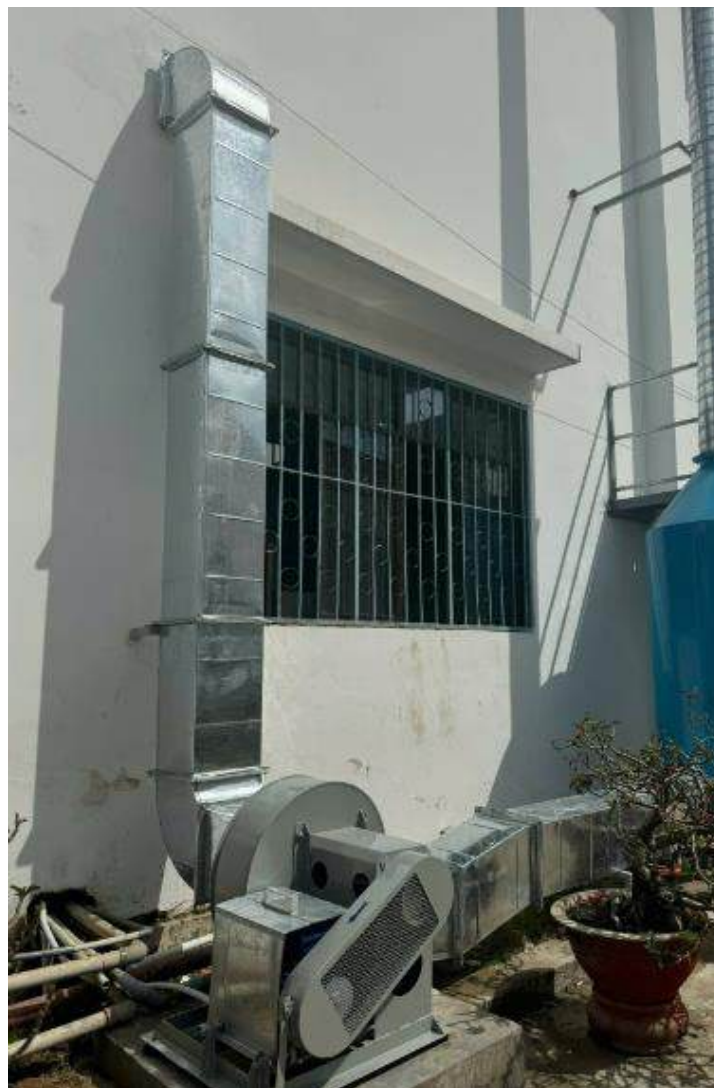
Đường ống thu gom + quạt hút
