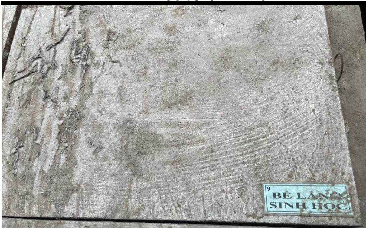
Hình 3. 15: Bể lắng sinh học
