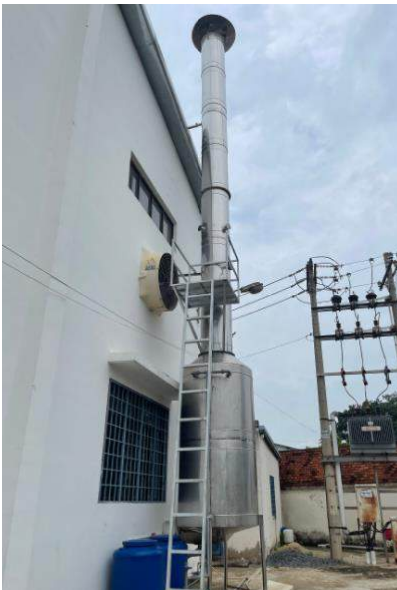
Hệ thống xử lý khí thải
