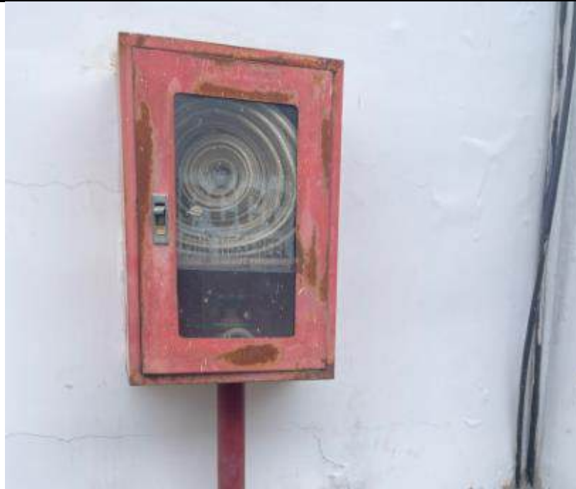
Hình 1. 20: Hệ thống PCCC tại cơ sở
