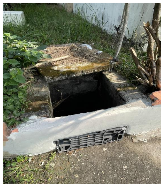
Hố ga tập kết nước thải sau xử lý
