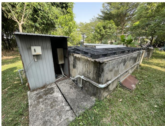
Hệ thống xử lý nước thải sinh hoạt 10m 3 /ngày.
