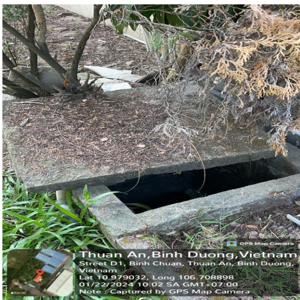
Hố ga tập kết nước thải trước xử lý
