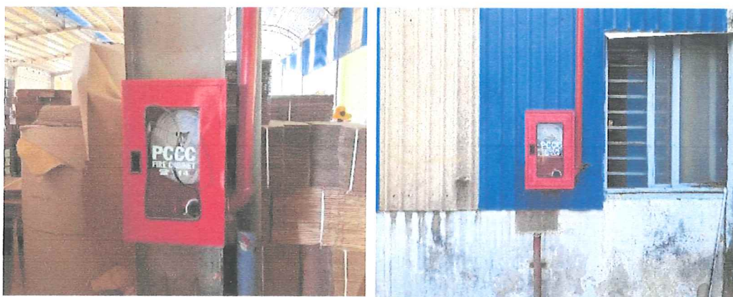
Hình 1.11. Các hộp PCCC tại cơ sở
