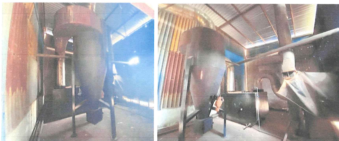
Hình 3.10. Hệ thống xử lý khí thải lò hơi
