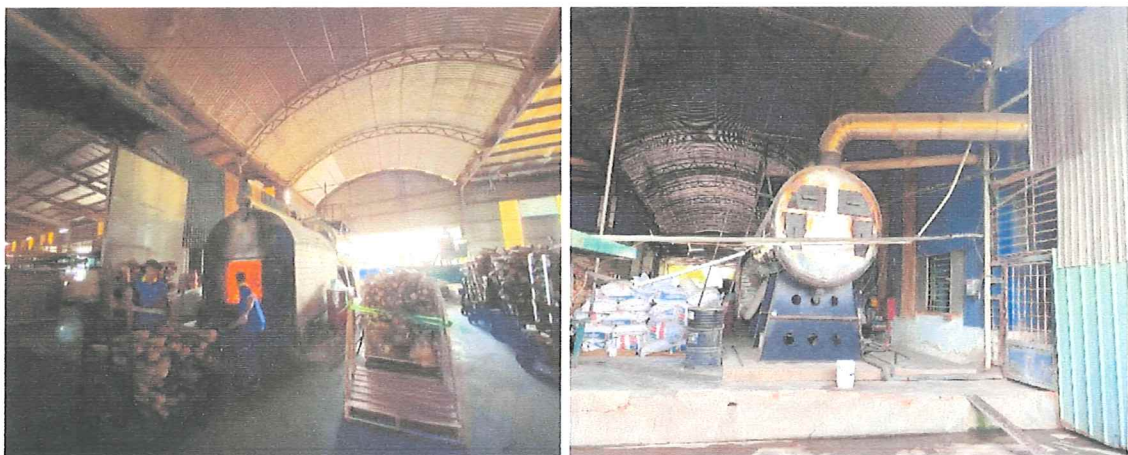
Hình 1.5. Hệ thống lò hơi tại cơ sở
