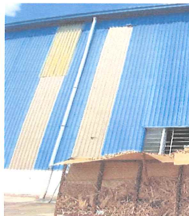
Ống nhựa thu gom nước mưa trên mái nhà
