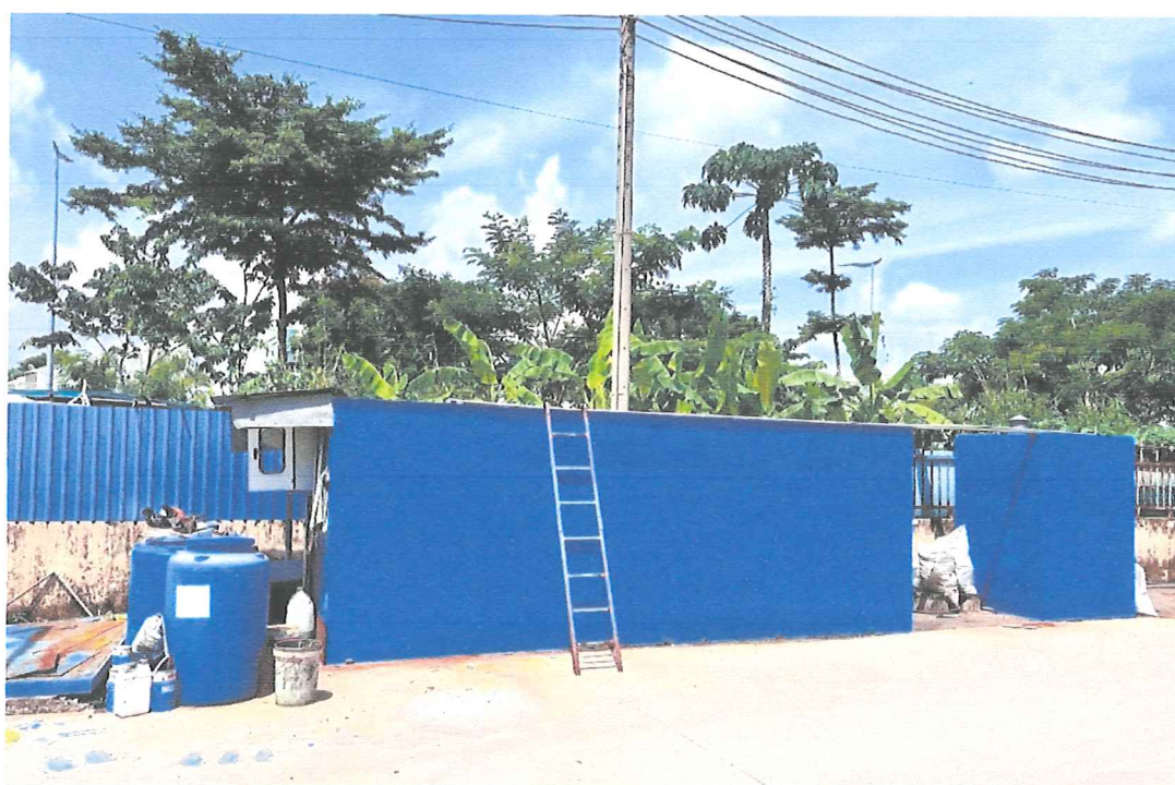
Hình 3.7. Hệ thống xử lý nước thải tập trung tại cơ sở
