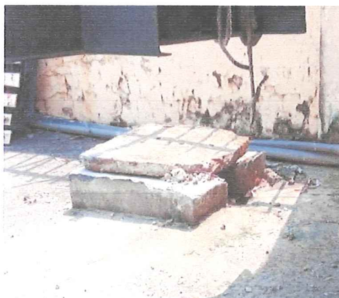
Hố ga thu gom nước mưa
