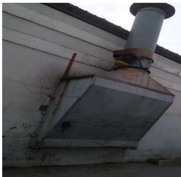
Hệ thống xử lý hơi dung môi và bụi sơn bằng màng hấp thụ bụi đặt dọc bên ngoài nhà xưởng 2 (B)
