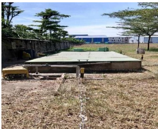
Hệ thống xử lý sơ bộ nước thải 1 – Nhà ăn
