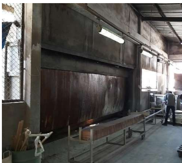
Hệ thống xử lý hơi dung môi và bụi sơn bằng nước
