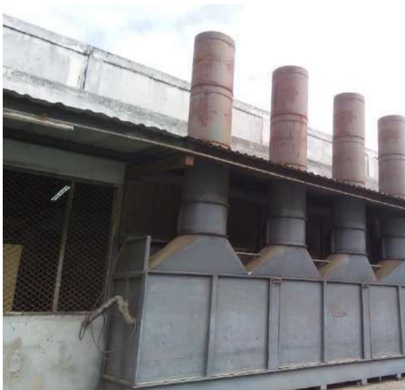
Hệ thống xử lý hơi dung môi và bụi sơn bằng nước đặt dọc bên ngoài nhà xưởng 1 (A)
