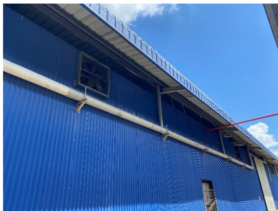
Ống thu nước mưa trên mái
