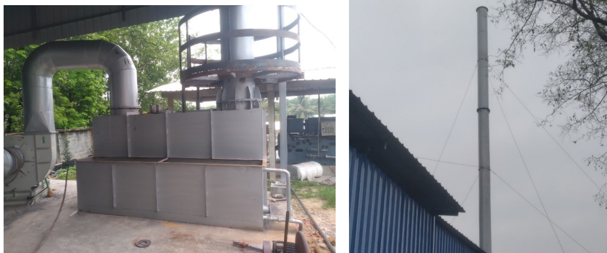
Hình 3.7. Hệ thống xử lý khí thải lò hơi của nhà máy
