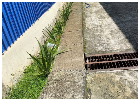
Mương thoát nước mưa
