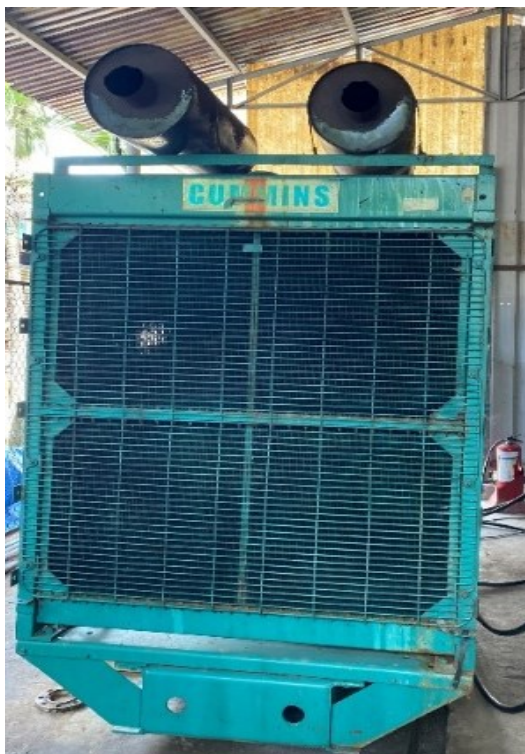
Hình 3.8. Máy phát điện dự phòng của nhà máy
