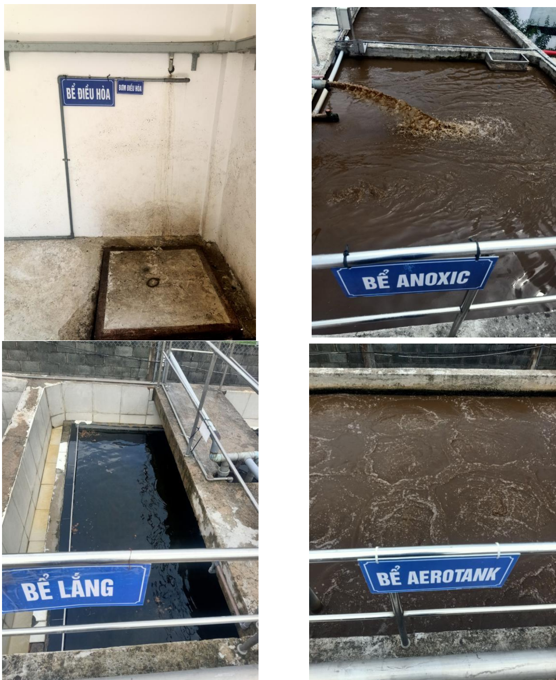
Hình ảnh hệ thống xử lý nước thải
