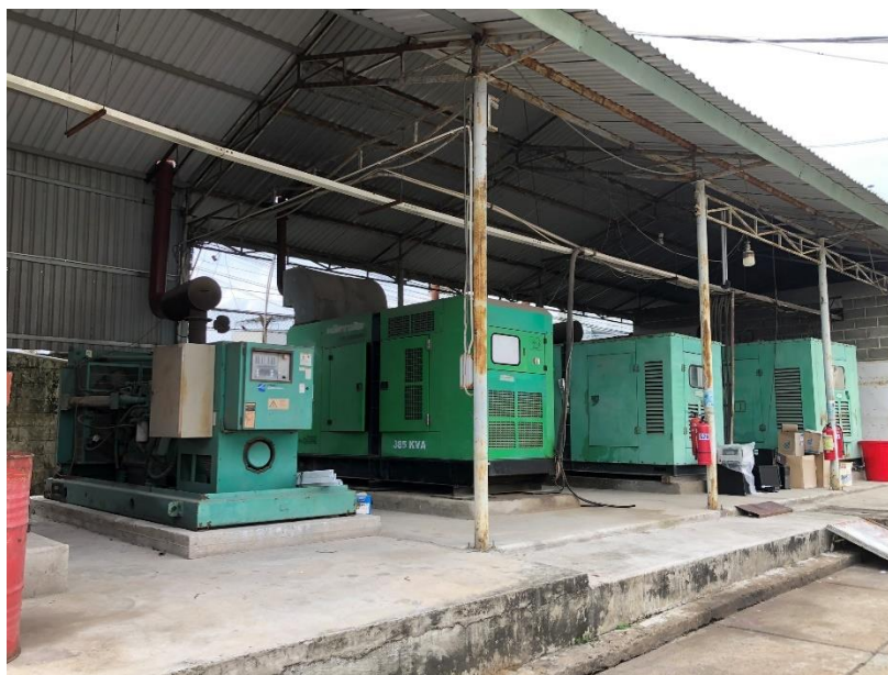
Khu vực máy phát điện
