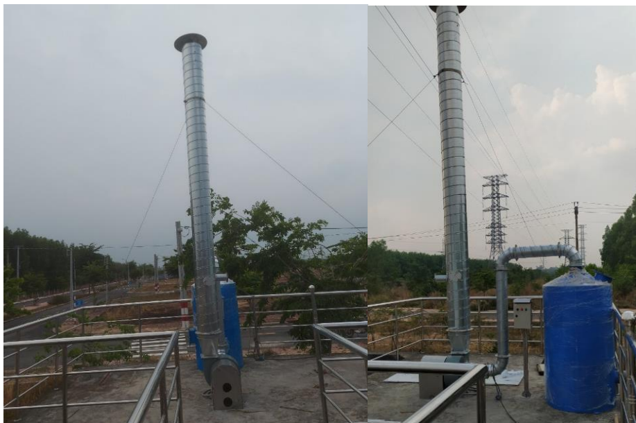
Hình 3. 11. Hệ thống xử lý mùi cho hệ thống xử lý nước thải của Dự án
