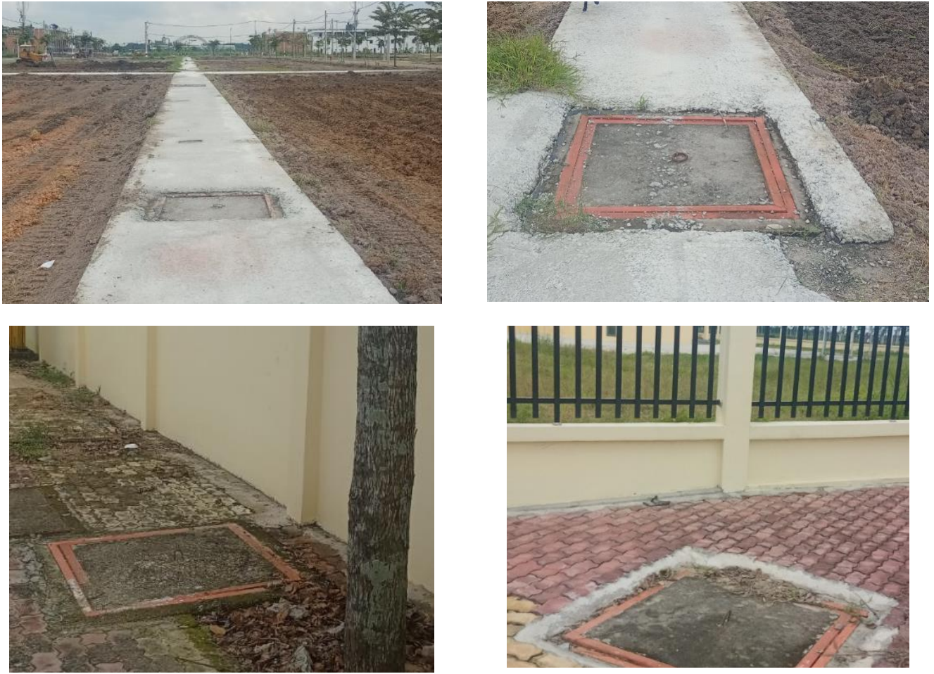
Hình 3. 3. Hệ thống thoát nước thải tại Dự án
