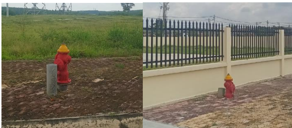
Hình 3. 13. Trụ cứu hỏa tại khu nhà ở
