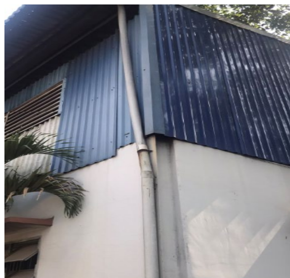
ống thu gom nước mưa trên mái nhà
