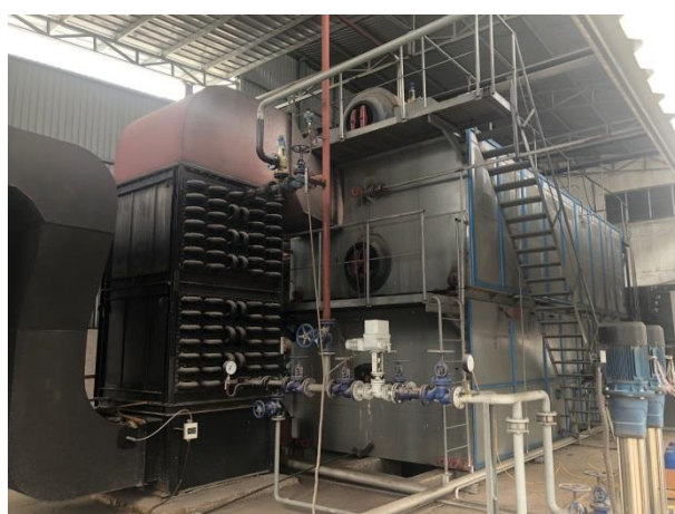
Hệ thống xử lý khí thải lò hơi 15 tấn/h
