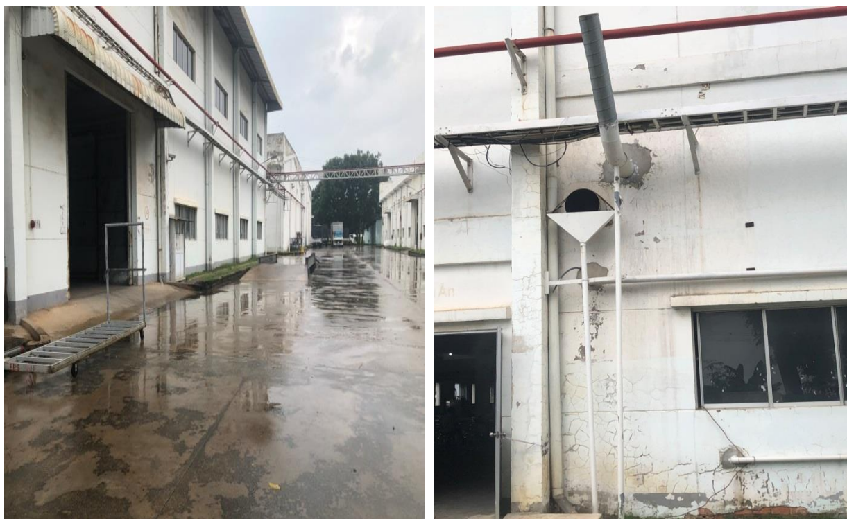
Hình 3. 3. Ống thu gom nước mưa trên mái
