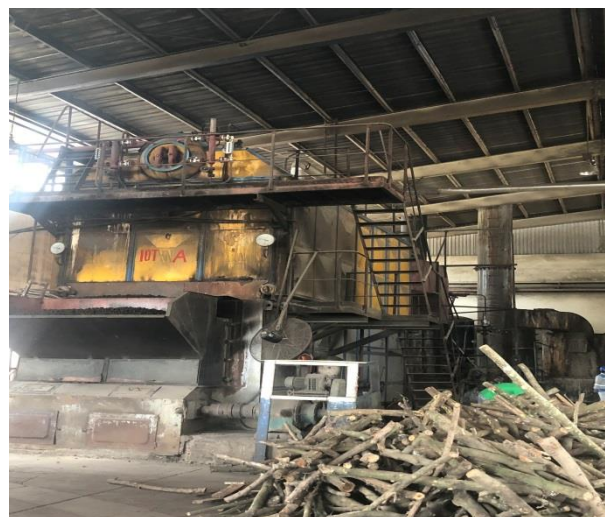
Hệ thống xử lý khí thải lò hơi 10 tấn/h
