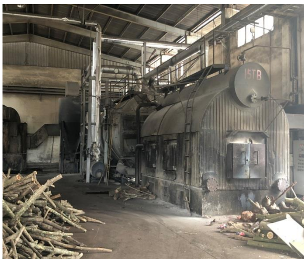
Hệ thống xử lý khí thải lò hơi 15 tấn/h
