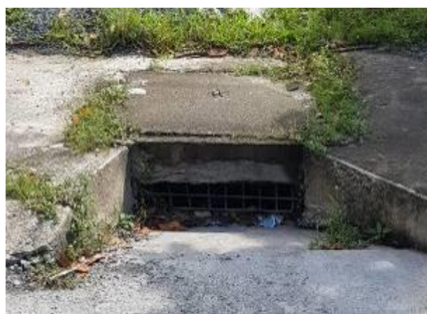
Hình 3.3. Hồ ga đầu nối nước mưa vào hệ thống thoát nước mưa của KCN.
