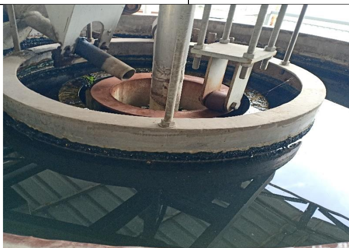
Bể tuyển nổi
