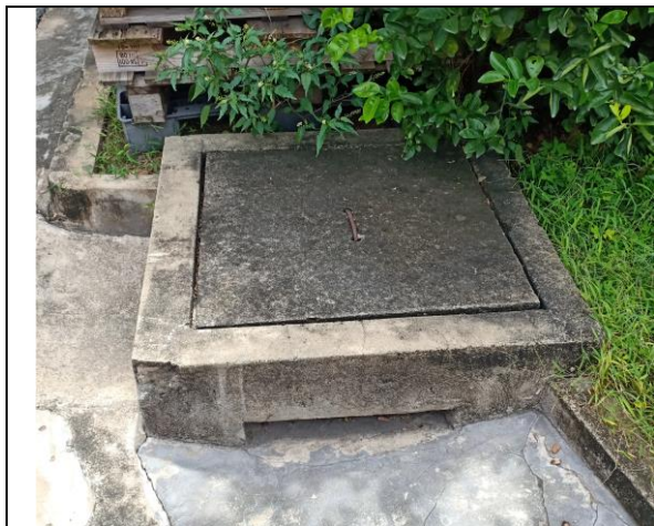
Hình 3.2. Hồ ga thu gom nước mưa nội bộ
