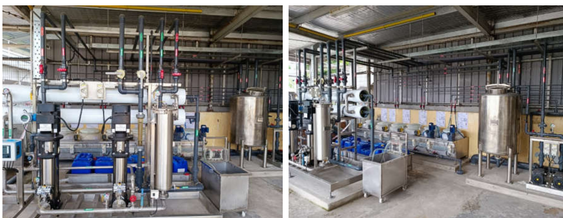
Hình 3. 10 Khu vực HTXL tái sử dụng nước thải sau xử lý
