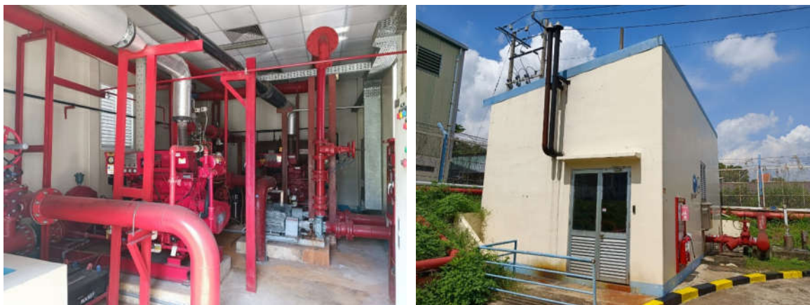
Hình 3. 19 Hệ thống PCCC tại Nhà máy
