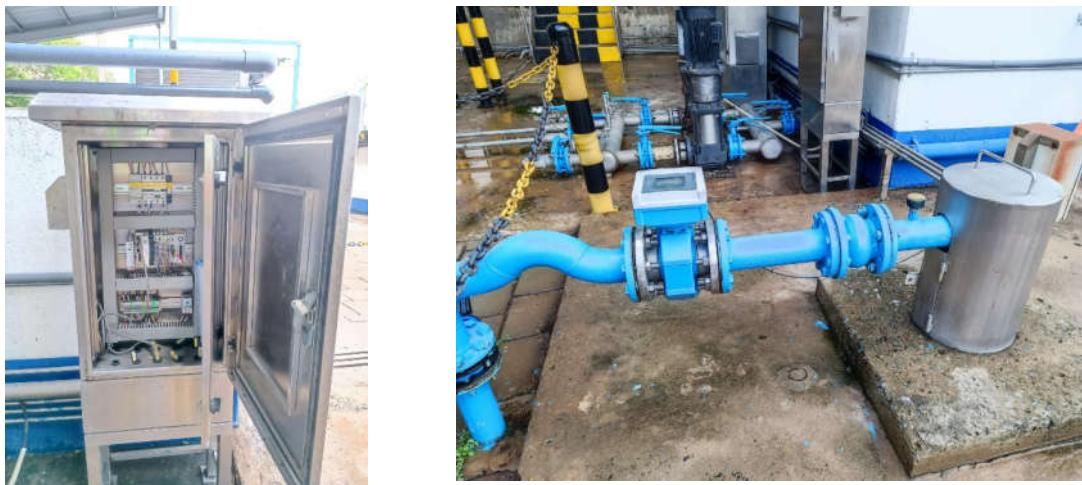
Hình 1. 8 Tủ điều khiển và đồng hồ đo lưu lượng nước ngầm khai thác tại Nhà máy
