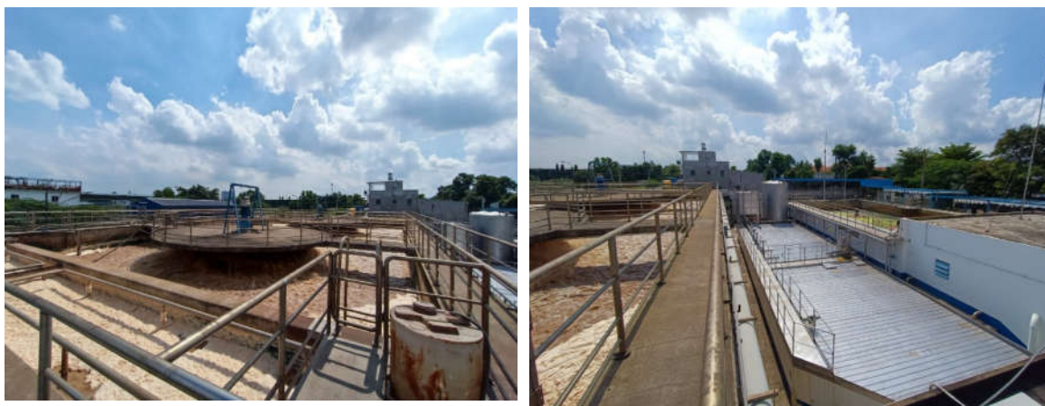
Hình 3. 7 Một số hình ảnh HTXL nước thải (bên trái bể aerotank, bên phải cụm bể cải tạo HTXL nước thải sinh hoạt)
