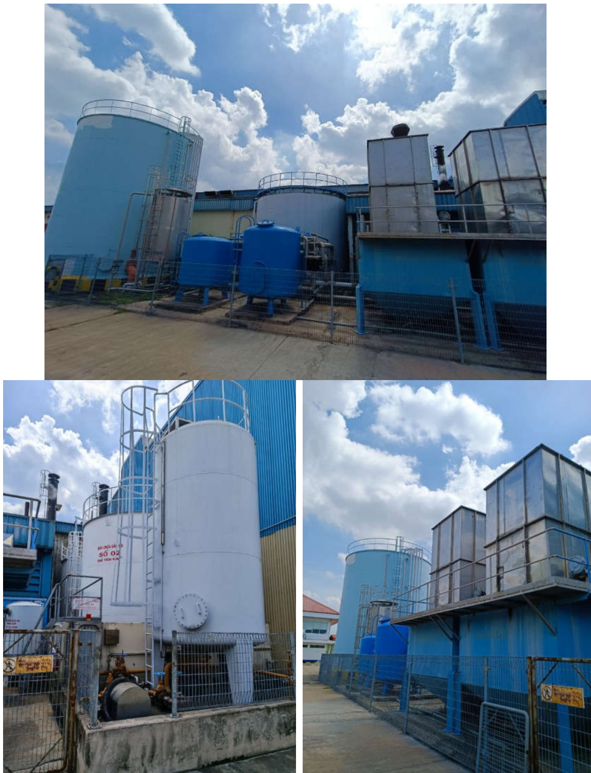
Hình 1. 10 Hình ảnh thực tế HTXL nước ngầm tại nhà máy
