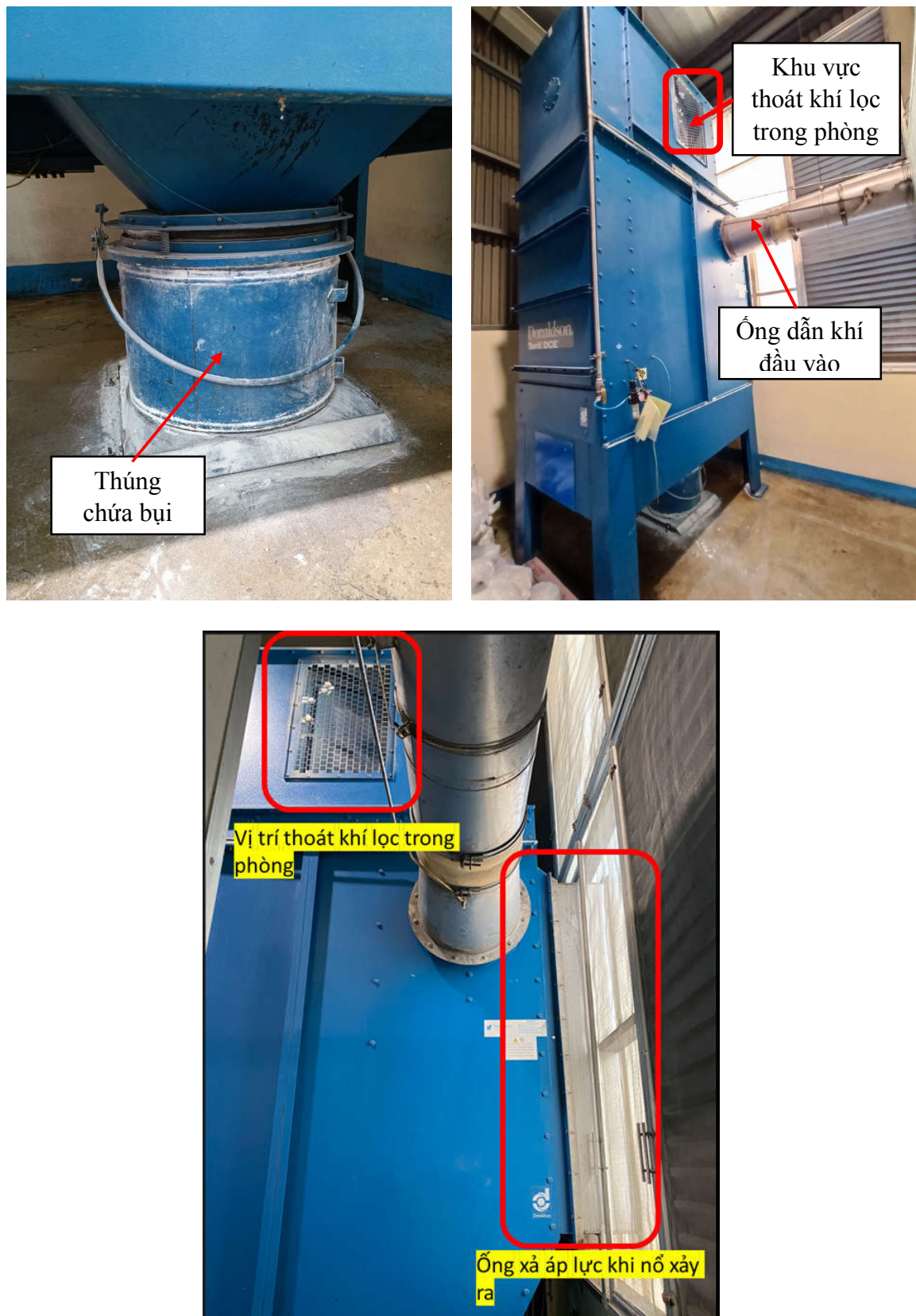
Hình 3. 12 Hệ thống lọc bụi sữa ở công đoạn trộn nguyên liệu
