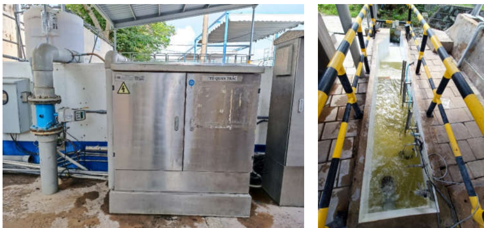
Hình 3. 8 Khu vực quan trắc tự động nước thải sau xử lý
