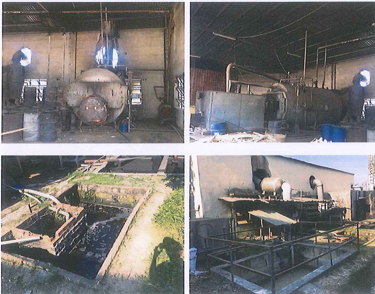
Hình 3. 19. Khu vực lò hơi và hệ thống xử lý khí thải lò hơi
