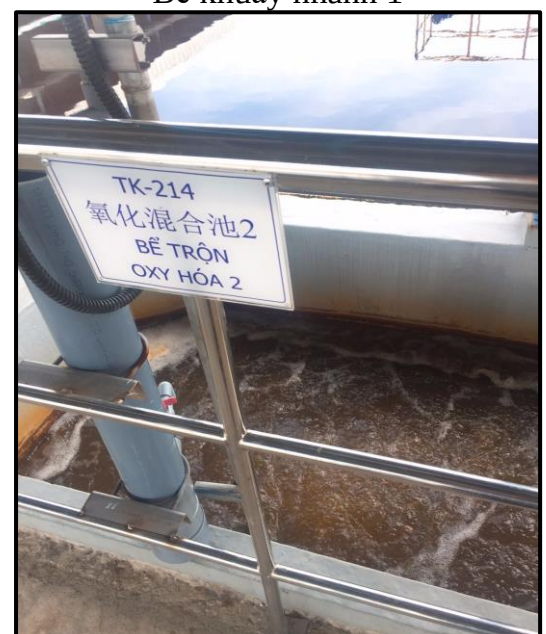
Bể trộn oxy hóa 2
