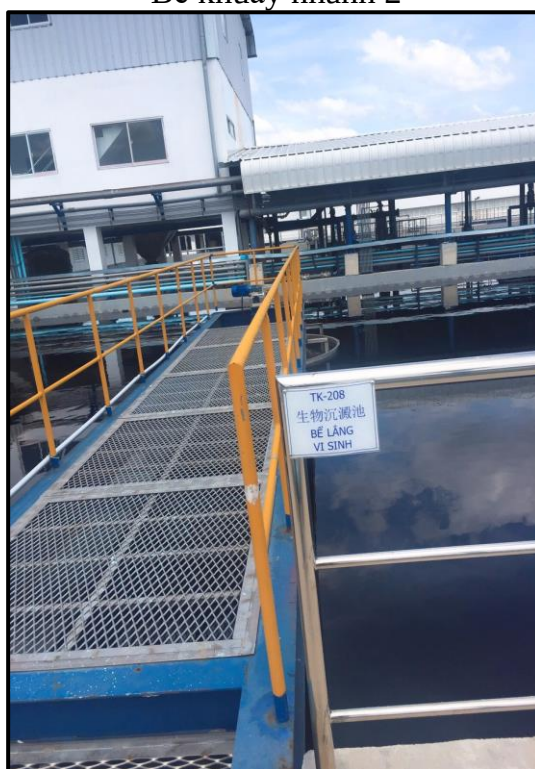
Bể lắng vi sinh
