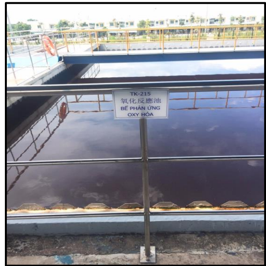
Bể phản ứng oxy hóa
