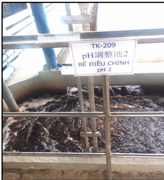
Bể điều chỉnh pH2
