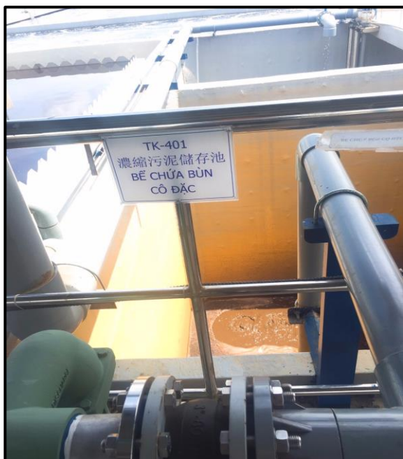
Bể chứa bùn cô đặc
