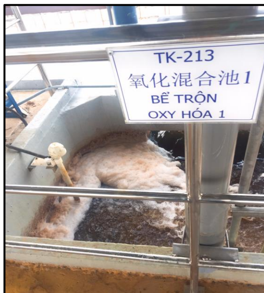
Bể trộn oxy hóa 1
