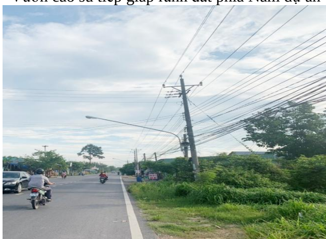
Hiện trạng trụ điện, TTLL, chiếu sáng trên đường ĐT 746
