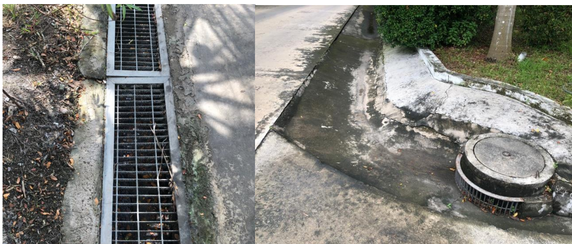
Hình 3. 2. Mương thu gom nước mưa
