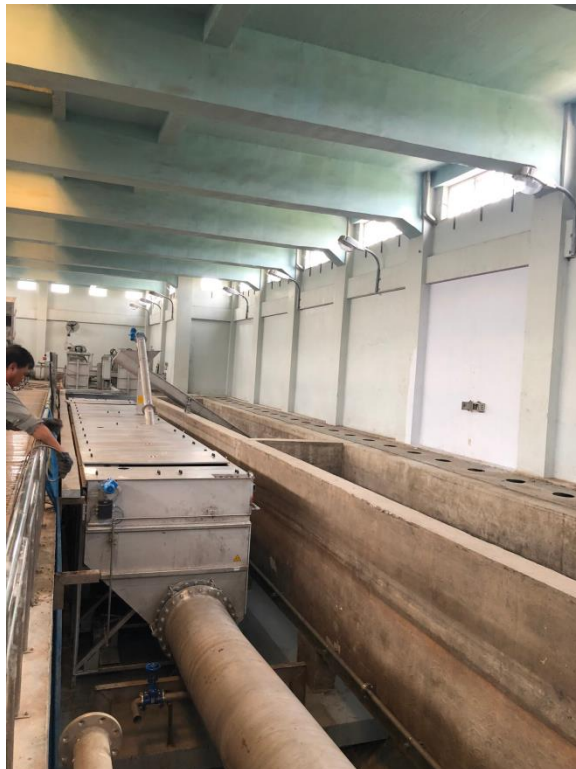
Bể lắng cát thổi khí GD2
