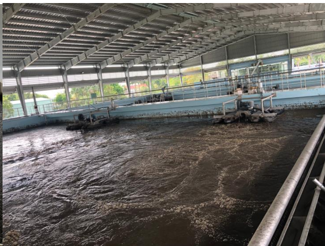
Cụm bể phản ứng ASBR GD2
