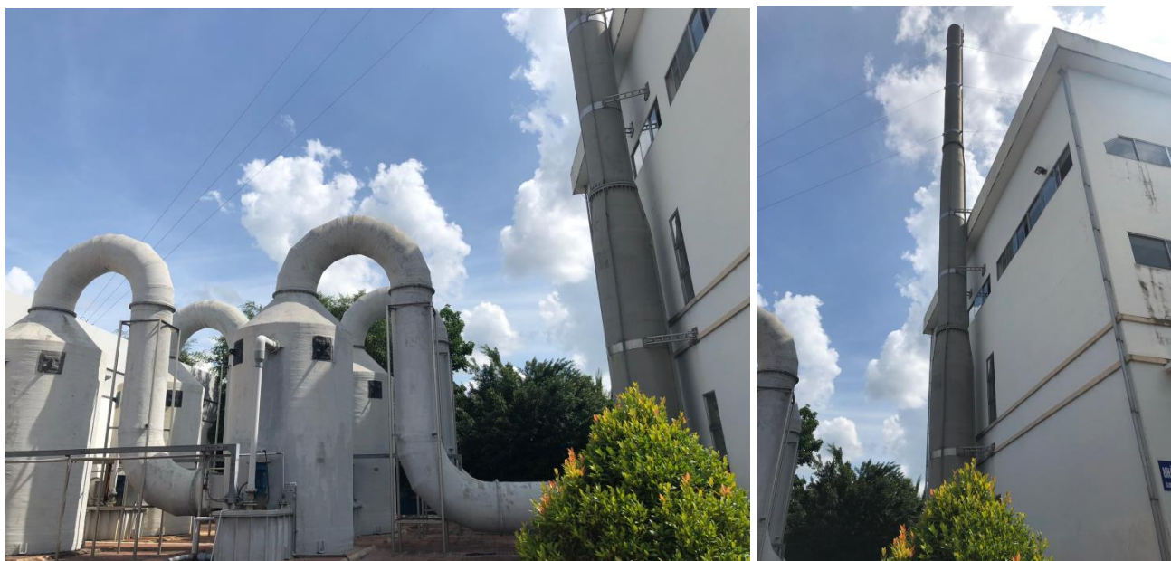
Hình 3. 7. Hệ thống xử lý mùi
