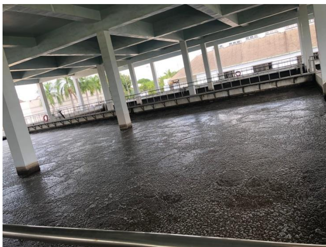
Cụm bể phản ứng ASBR GD1
