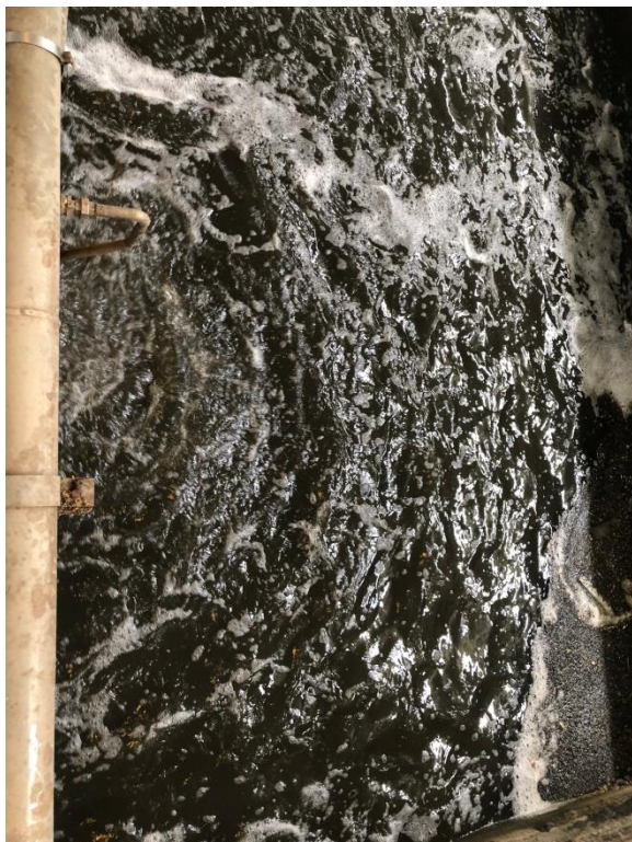
Bể lắng cát thổi khí GD1
