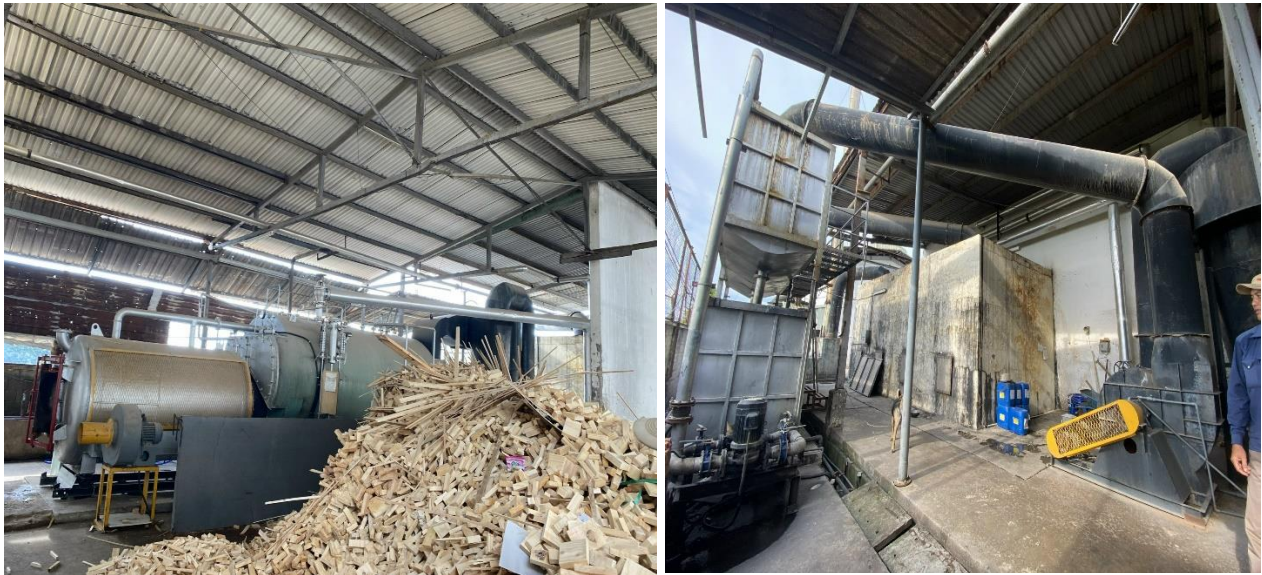
Hình 3. 6. Hình ảnh lò hơi tại công ty
