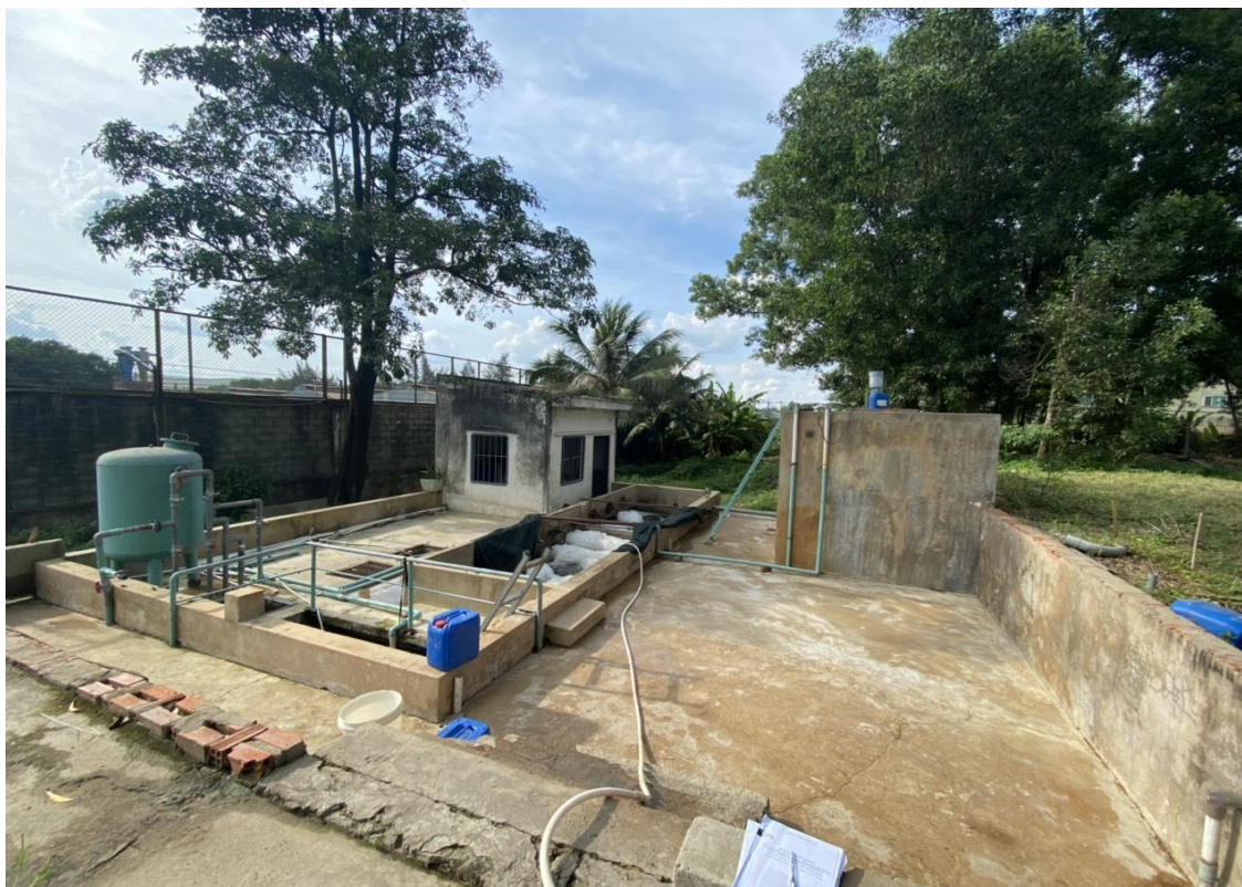
Hình 3. 4. Hệ thống xử lý nước thải công suất 250 m 3 /ngày.đêm
