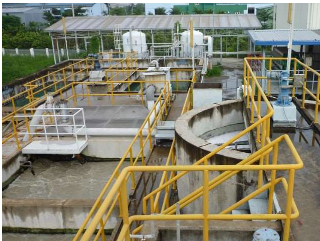
Hình 8. Hình ảnh hệ thống xử lý nước thải của Công ty
