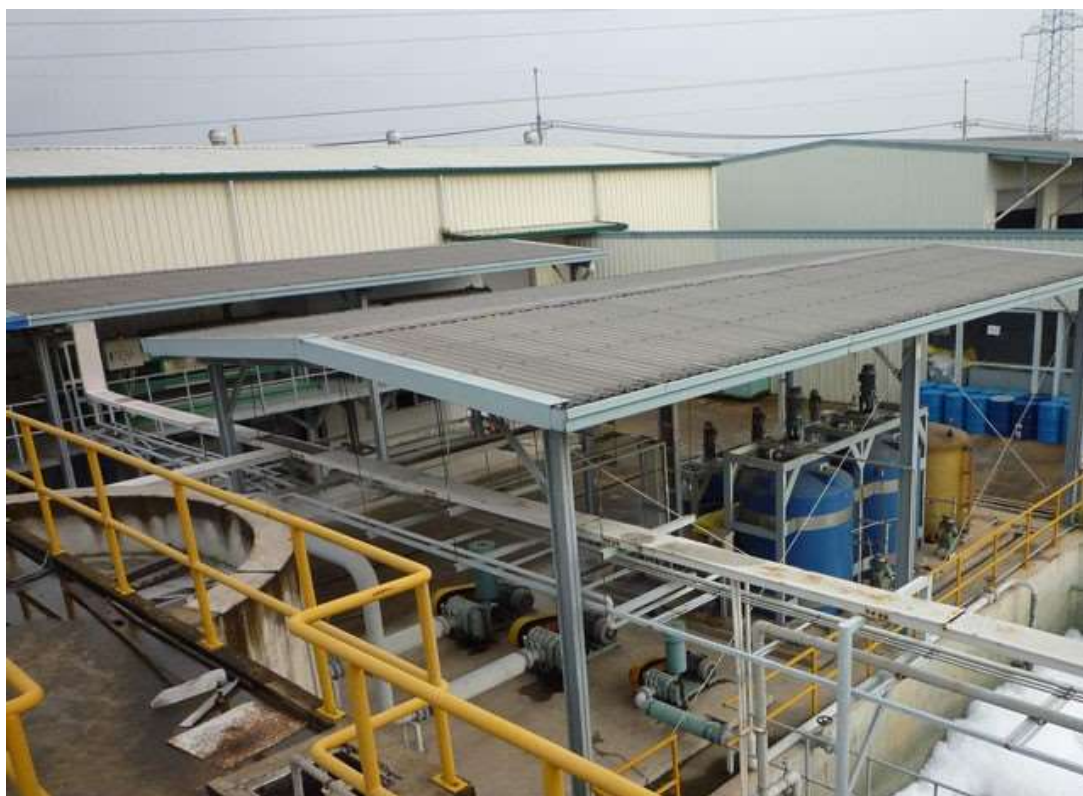
Hình 7. Hình ảnh hệ thống xử lý nước thải của Công ty
