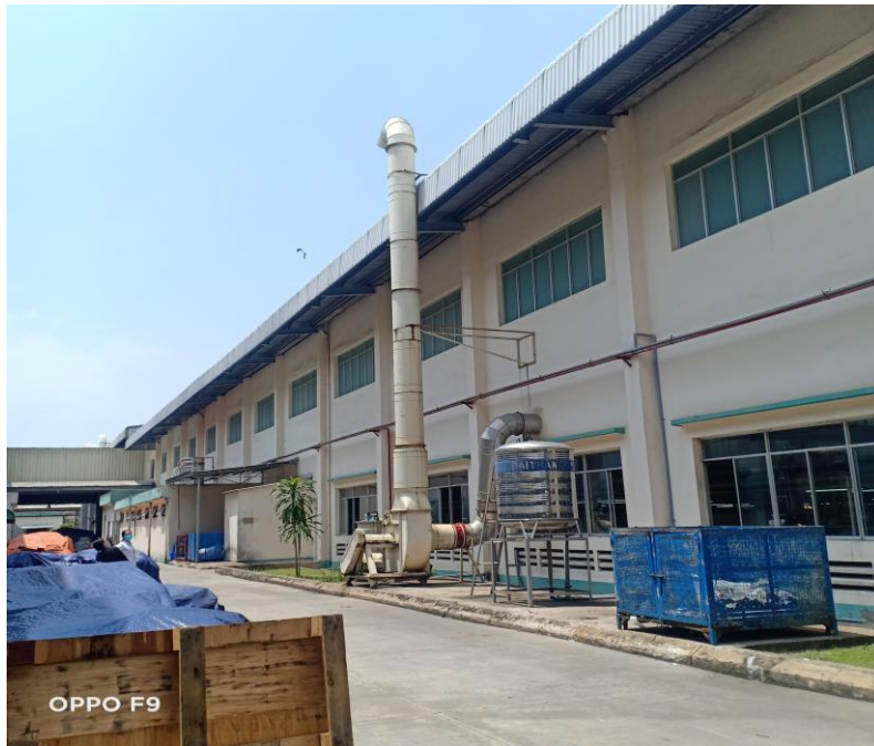
HTXL công đoạn rửa hiện hữu
