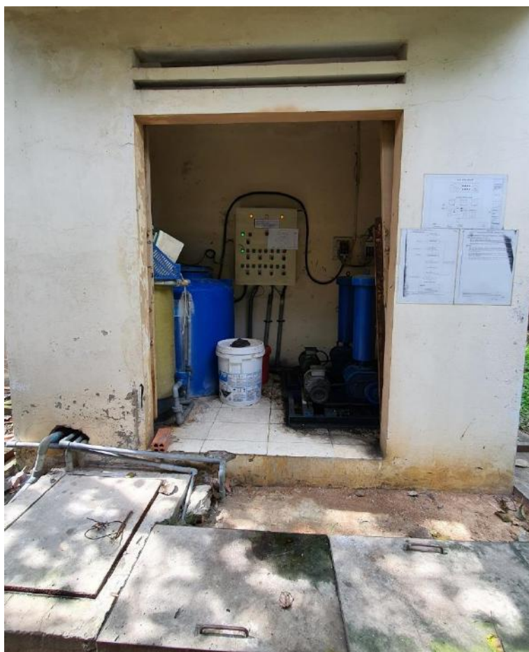
Hình 6. Hệ thống xử lý nước thải tại công ty
