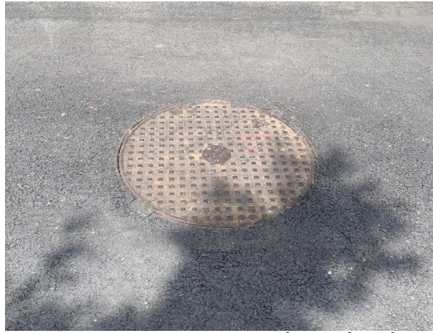
Hình 3.2: Hố ga đầu nối nước thải
