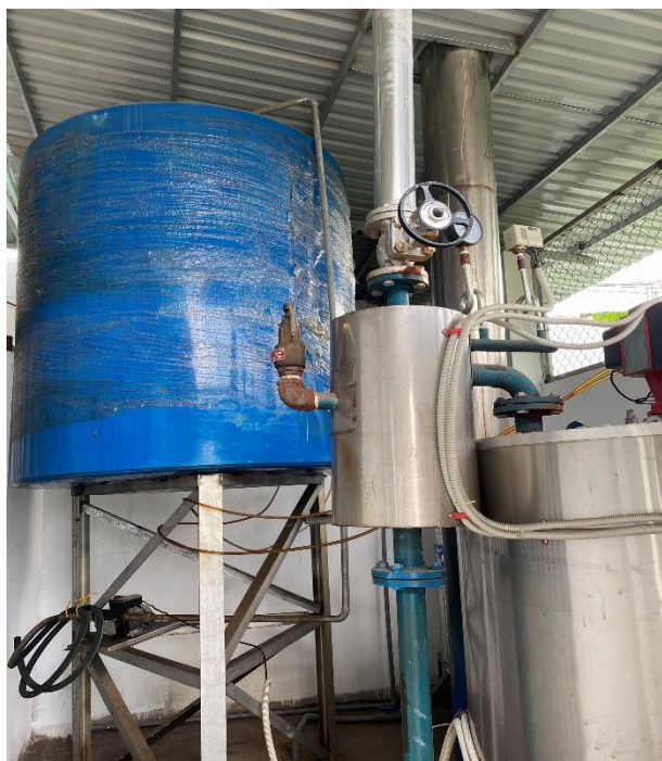
Hình 1. 6. Lò hơi đốt dầu DO
