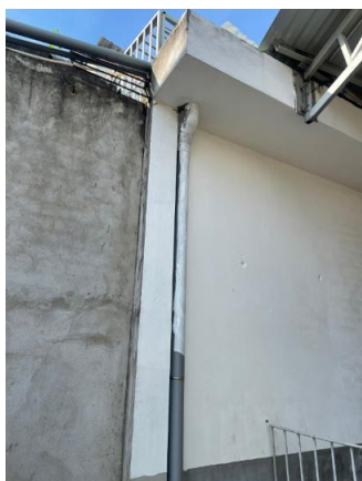
Hình 3. 2. Hệ thống ống thu gom nước mưa từ mái
