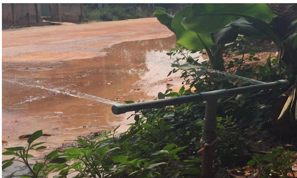
Hình 3.15. Hệ thống phun nước giảm bụi trên đường
