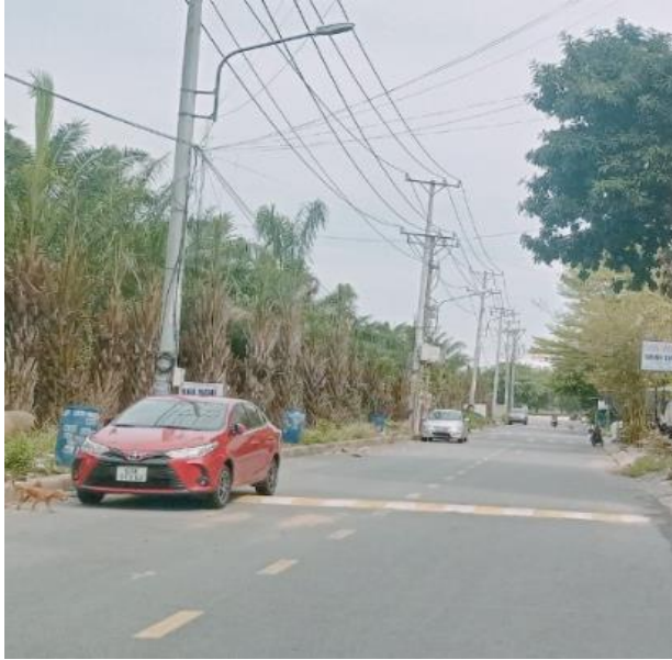
Hình 1. 10. Hệ thống đèn chiếu sáng tại khu quy hoạch
