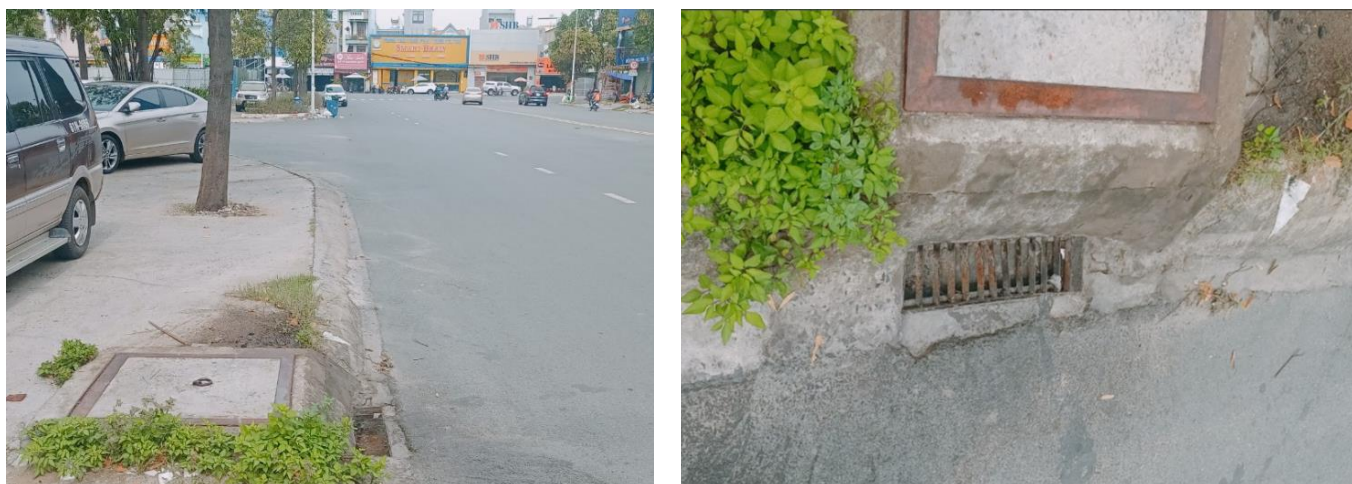
Hình 3. 2. Hệ thống thoát nước mưa tại Dự án
