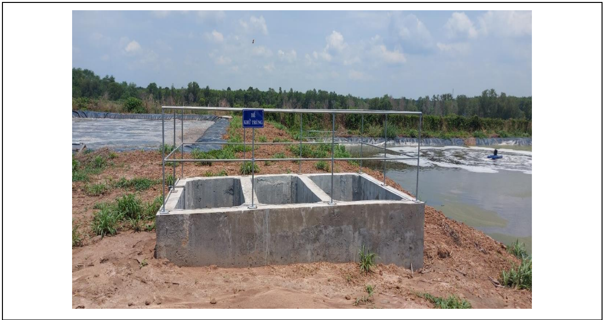
Hình 3. 9. Hình ảnh bể khử trùng
