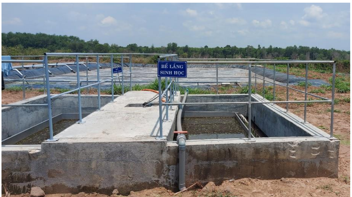
Hình 3. 8. Hình ảnh bể lắng sinh học
